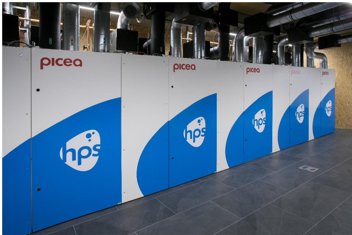
Die Energiezentrale „PICEA“ des energieautarken Firmengebäudes der Josef Küpper Söhne GmbH in Meckenheim
