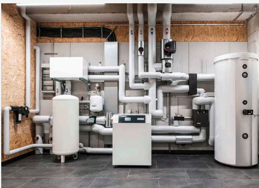
Zusätzlich zur Wasserstoffheizung wurde der Neubau noch mit einer Geothermieanlage ausgestattet.
