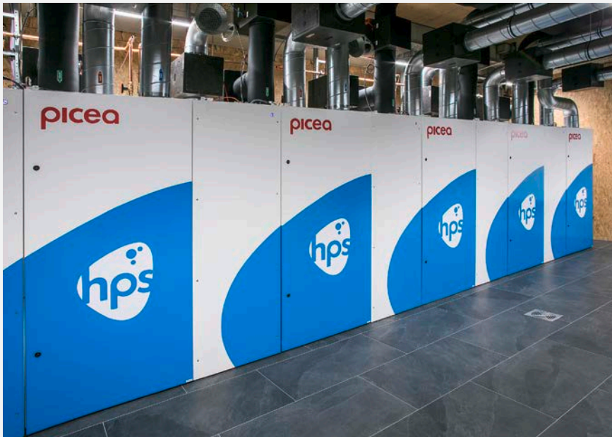
Die Energiezentrale picea von HPS spaltet mittels Elektrolyse Wasser in grünen Wasserstoff und Sauerstoff.
