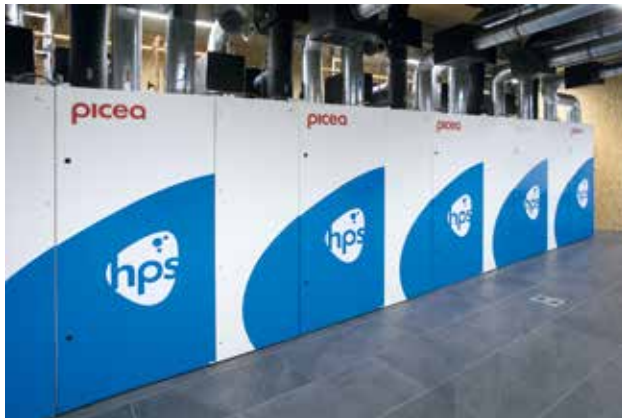
picea - die Energiezentrale
