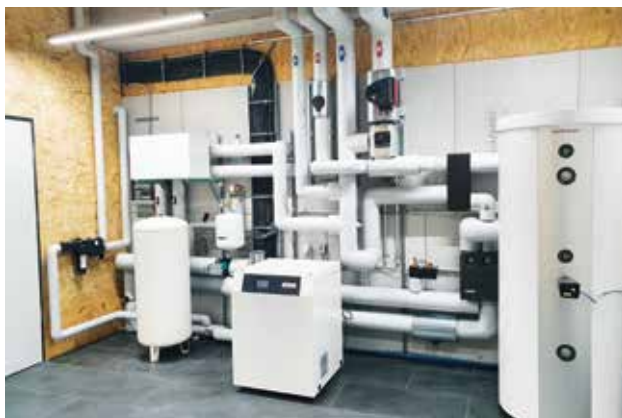
Erdwärmepumpe zum Heizen und Kühlen, mit 17,5 kW Heizleistung
