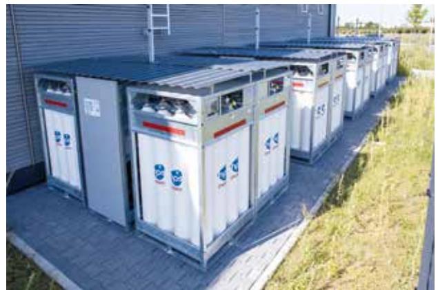
Wasserstoffspeicher 440 kg H 2
